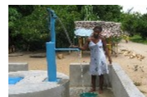
puits -pompe manuelle
